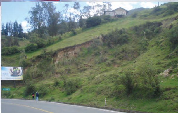
Figura 13.- Cicatric de deslizamiento junto a vía Panamericana.
