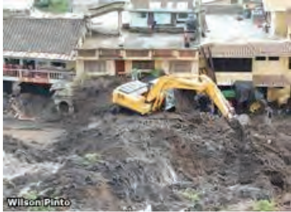
Figura 49.- Imagen de evidencia de un gran deslizamiento.
